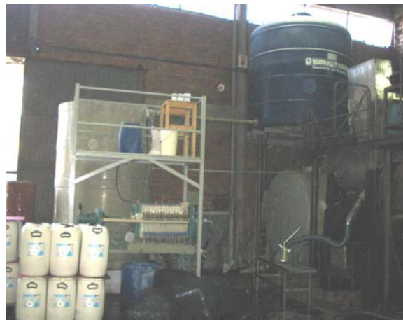
Figura 12 – Fotografia da estação de tratamento de efluentes da empresa estudada
