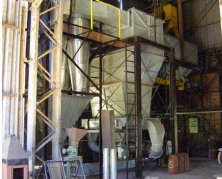
Figura 4 - Unidade piloto de combustão fluidizada da Fundação de Ciência e Tecnologia do Estado do Rio Grande do Sul, Cachoeirinha, RS.
